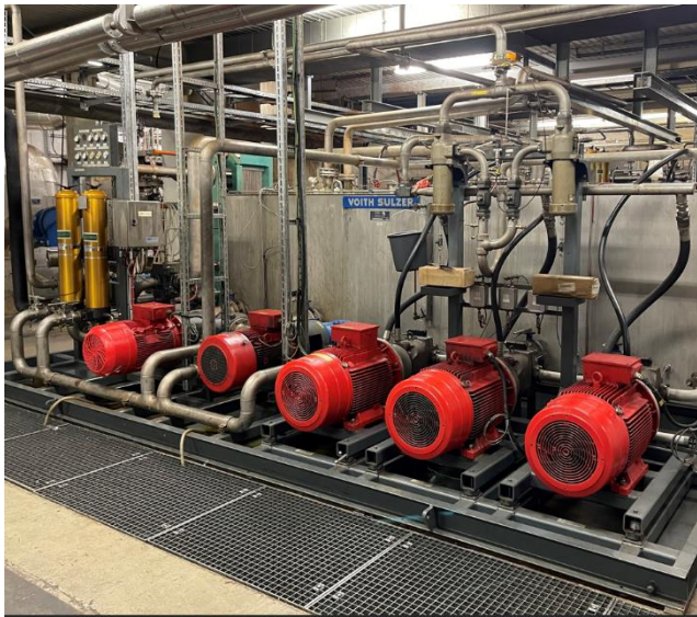
Figura 13: Sistema hidráulico para refrigeração e lubrificação de rolamentos como parte do Nipco-Roll
